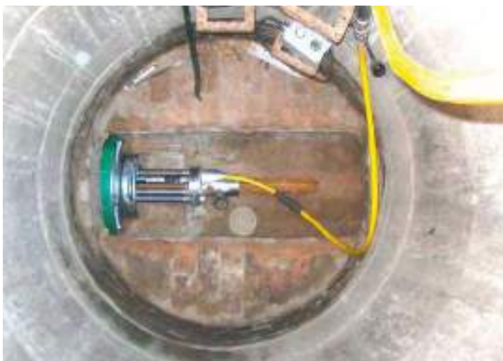
BURSTFIX 200 im Schacht.
